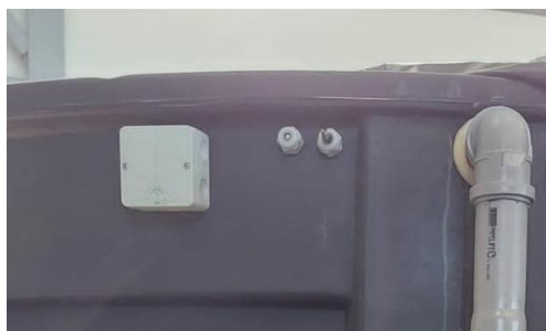
Bild 7: Kopplingsdosa utanpå InterACT, kabel från värmekabel samt luftpump ska dras genom genomföringarna och kopplas in i den vita kopplingsdosa.
