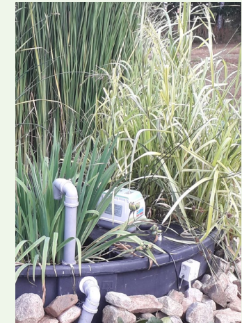
Bild 2: Kopplingsdosa till luftpump (inringad i rött)
